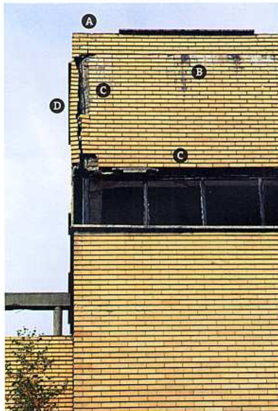
Figure 22 Le mirador, vu de la terrasse, niveau 3, état en 2001. A : souche de la cheminée rapportée par P. Barbe dans l'ex-salle de jeux. B : la disparition des couvertines en pierre a entraîné de nombreux décollements du placage en briquette. C : autre cause, la recharge, par le maçon, du parement béton en planelles de terre cuite plâtrières et gélives. D : la baie panoramique a été bouchée durant la guerre pour installer une DCA sur la terrasse. © CRMH Nord-Pas-de-Calais.
